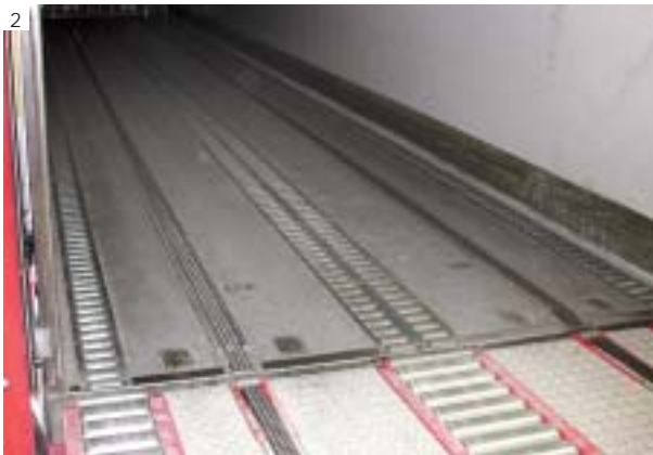
N. 2 - Sistemi integrati di carico-scarico di semirimorchi e banchine Loading/unloading slipchain integrated systems at warehouse bay
